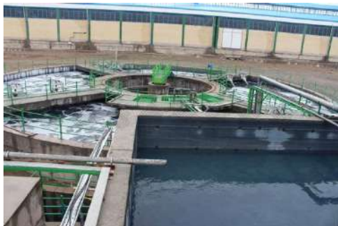
تصفیه‌خانه کارخانه نساجی
